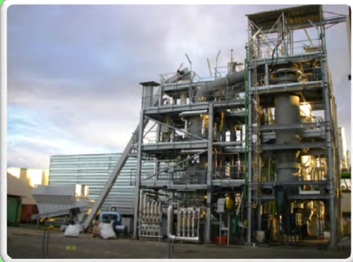
高効率廃棄物発電実証設備 (フランス) ガス化炉 (当社) + ガス改質炉 (EP社)
