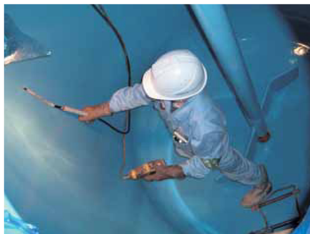
PPGガラスの缶内は明るく点検も容易です
