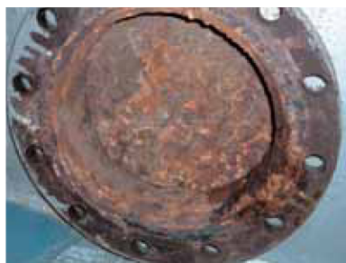
外套用フランジの腐食状況
