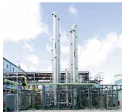
バイオ天然ガス化装置
