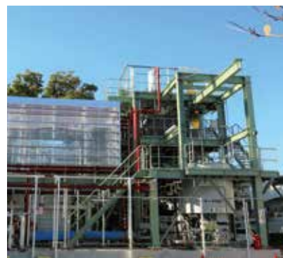
水熱炭化設備
