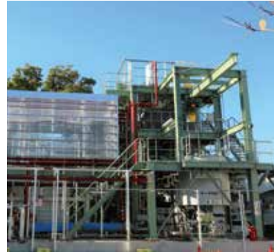
水熱炭化設備
