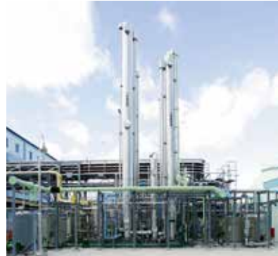
バイオ天然ガス化装置
