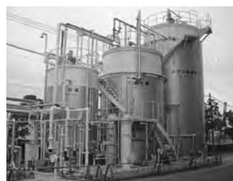
写真1 メタン発酵/汚泥可溶化設備
