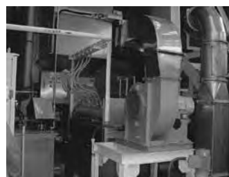
写真3 生ごみ破袋分別設備
