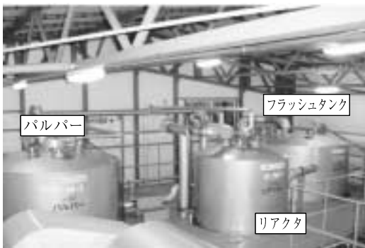
写真2 実証設備 (加水分解プロセス)
