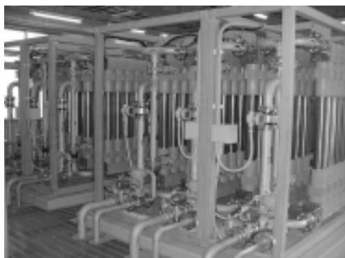
写真2 膜ろ過設備外観
