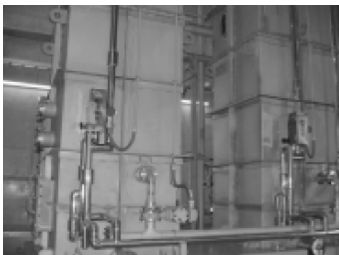
写真1 上向流式生物接触ろ過池外観
