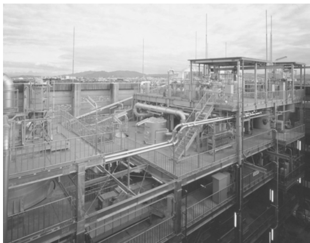
写真3 120 t/d 汚泥溶融設備全景
