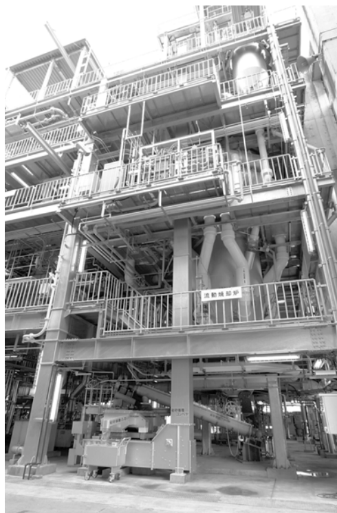
写真1 循環流動層炉全体
