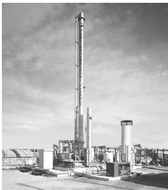
写真1 実証設備全景
