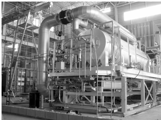
写真1 還元加熱パイロット試験設備の外観
