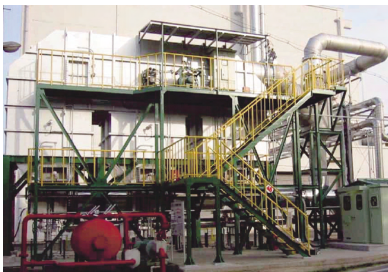
蓄熱式燃焼脱臭装置 (RTO) 外観
