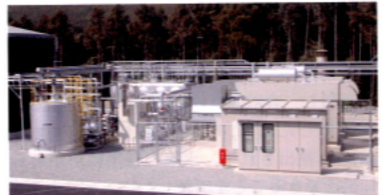
バイオガス利用設備 ガスエンジン（170 kW×2基）
