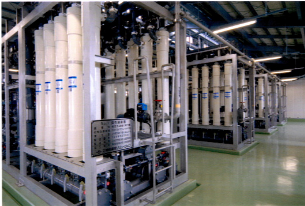
兵庫県赤穂郡上郡町殿 大枝新浄水場納入 浄水量 8 570 m 3 /d
