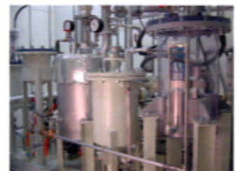
—油処理ステーション— PCB を脱塩素化無害化処理する
