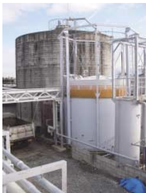
a) PANBIC-F システム（高濃度廃水処理設備）
