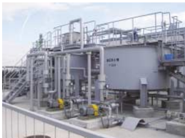
a) 加圧浮上装置
