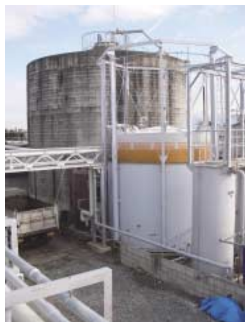
a) PANBIC-Fシステム（高濃度廃水処理設備）
