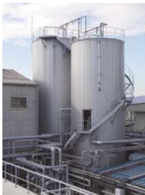
b) PANBIC-Hシステム（高効率廃水処理設備）
