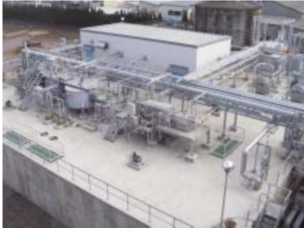
a) 好気処理設備
