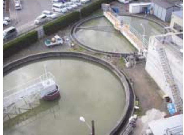
b) 最終沈殿槽 (既設流用)
