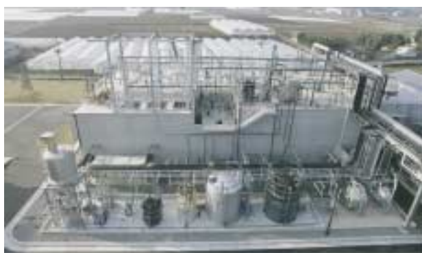
図6 排水処理設備外観
