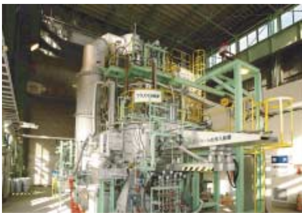
写真1 実証設備全景
