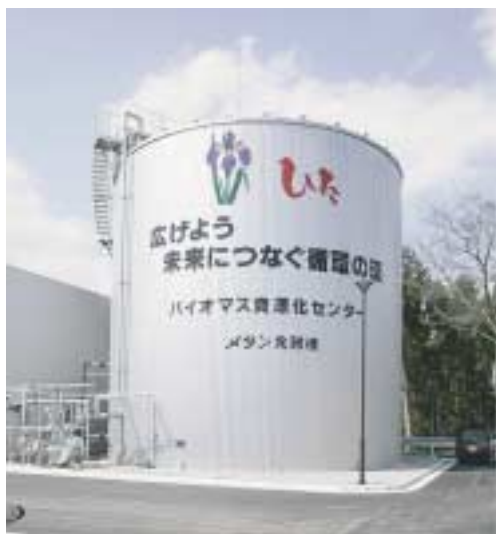
図5 メタン発酵槽外観
