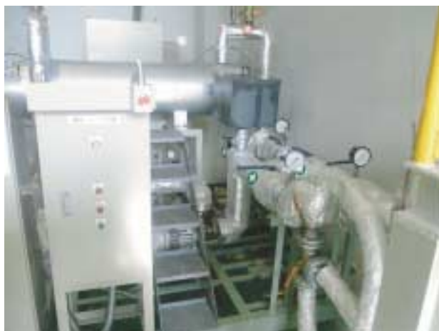
写真2 蓄熱ユニット
