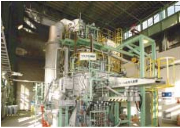
写真1 実証設備全景
