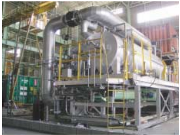
写真2 還元加熱試験設備の外観
