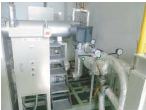
写真2 蓄熱ユニット
