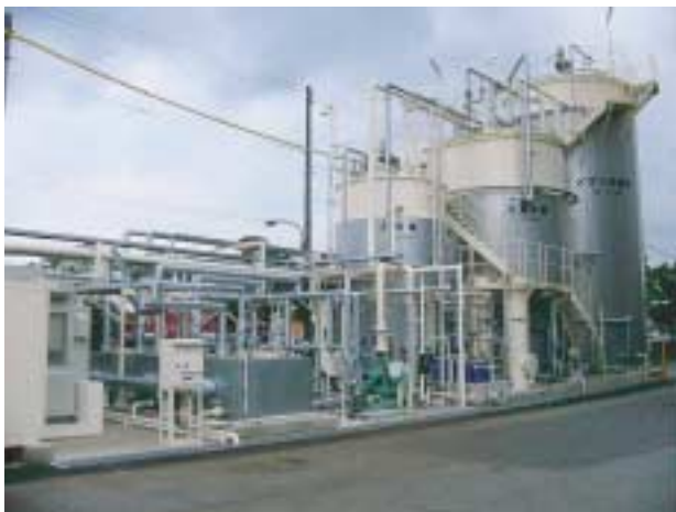
図2 コープこうべ殿向けメタン発酵設備 全景
