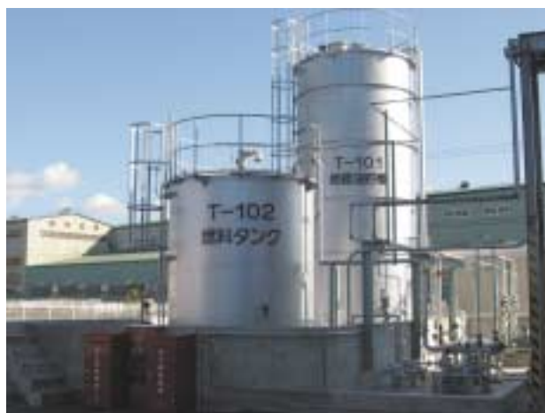
写真6 絶縁油貯槽および燃料タンク
