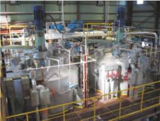
写真7 SD貯留設備
