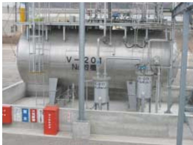
写真5 ナトリウム貯槽
