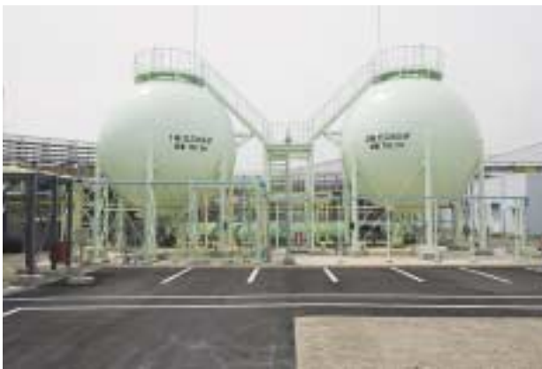
写真2 ガスタンク設備
