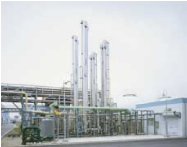
写真1 ガス精製設備
