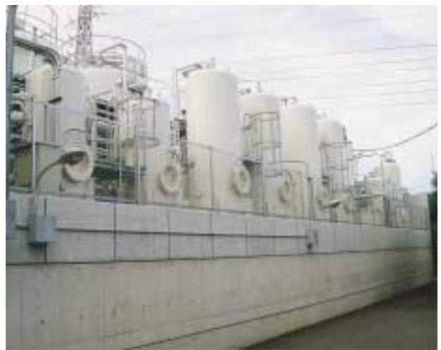
写真1 無機系排水回収設備
