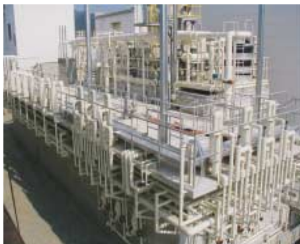
写真2 有機系排水回収設備
