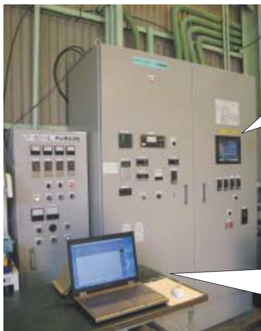
写真2 ワイブレン・EXEVA 共通制御盤
