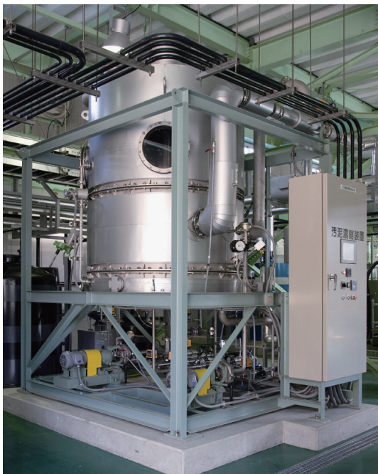
写真2 汚泥濃縮装置
