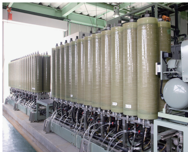
写真1 逆浸透膜処理装置 (DT モジュールシステム)
