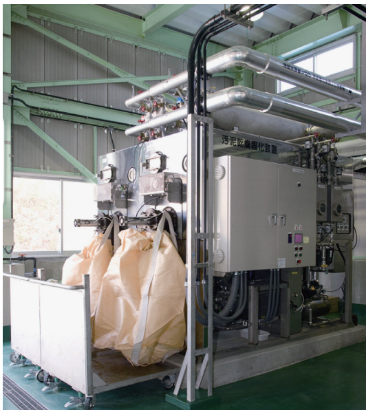
写真3 汚泥乾燥固化装置
