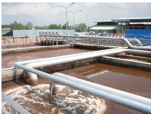
写真1 設備外観1（曝気槽）
