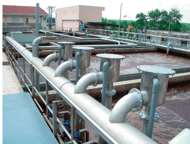
写真2 設備外観2（曝気槽）
