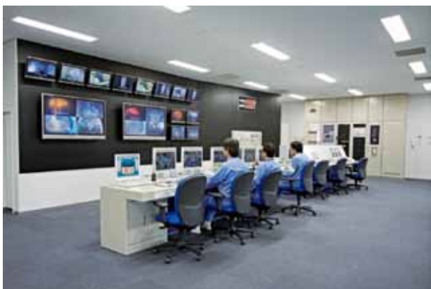
写真2 ごみ焼却施設の運転状況 (相模原市南清掃工場の中央制御室)
