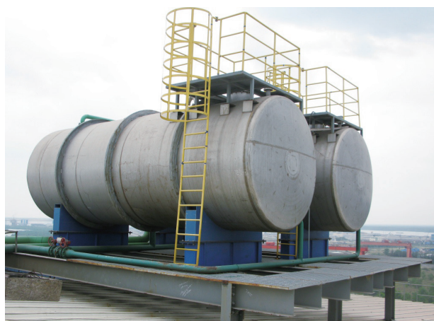
写真5 連続鋳造機用高架水槽
