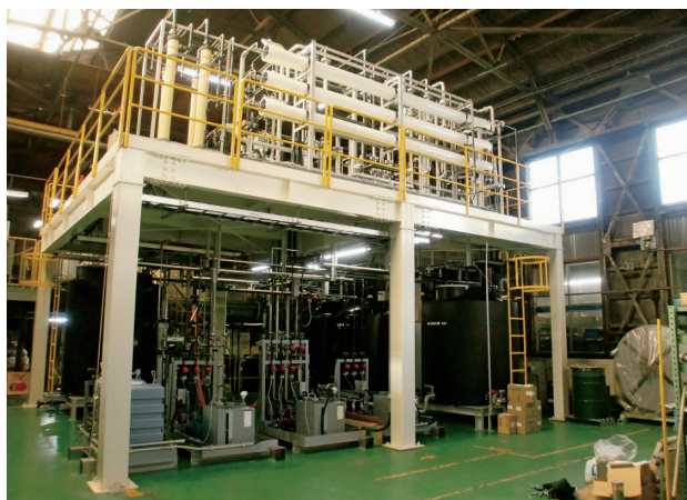
写真1 水リサイクル装置全景
