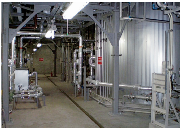
写真2 厨房除害設備外観（B5F）
