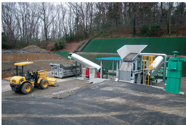
写真1 最終処分場前処理設備の外観
