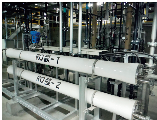
写真4 排水膜処理設備外観図
