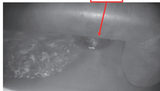
図7 不燃物貯留槽下スクリュウの異常状態
