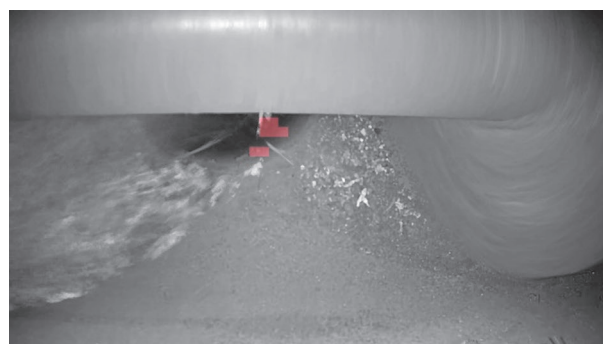
図8 不燃物貯留槽下スクリュウの異常検知状況
