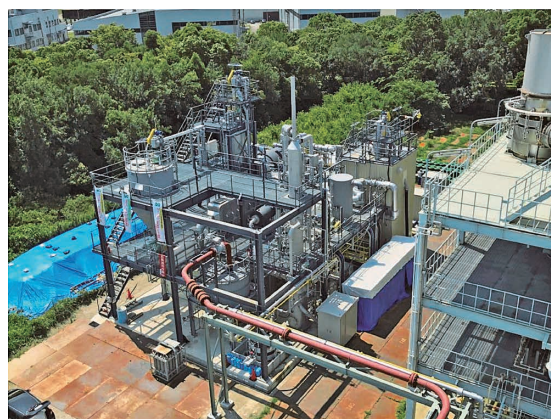
写真2 汚泥燃料化システム実証設備外観 （脱水汚泥処理能力10 t-wet/d）
