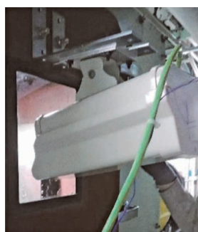
図2 カメラ設置状況
