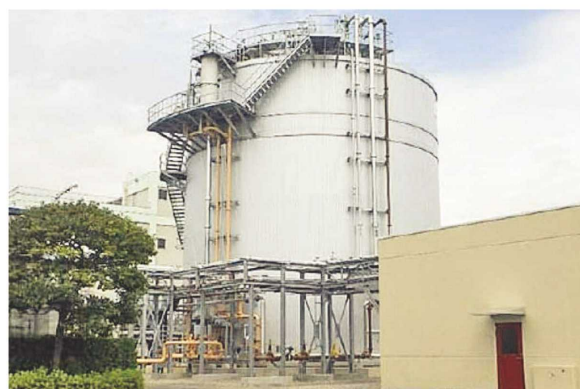
写真5 鋼板製消化槽
