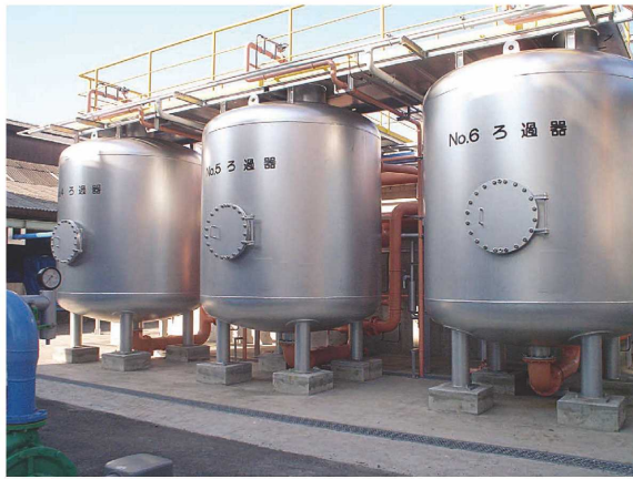
写真13 圧力式砂ろ過器 スーパーフィルター
