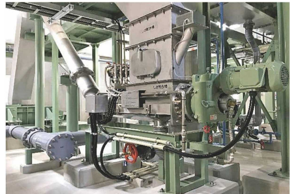
写真1 し渣洗浄脱水機
