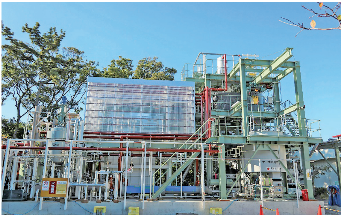
実証設備の外観（施設規模：脱水汚泥処理能力 5 t-wet/日）
