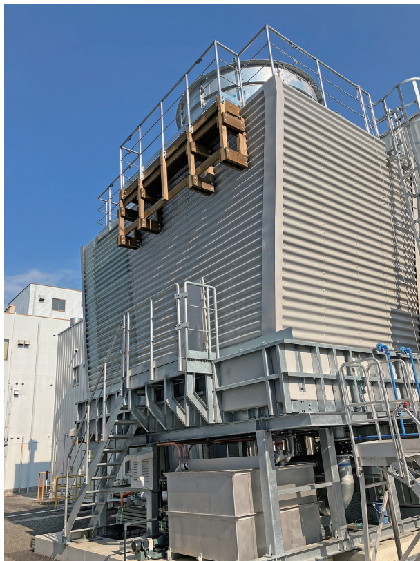
冷却塔実験設備
