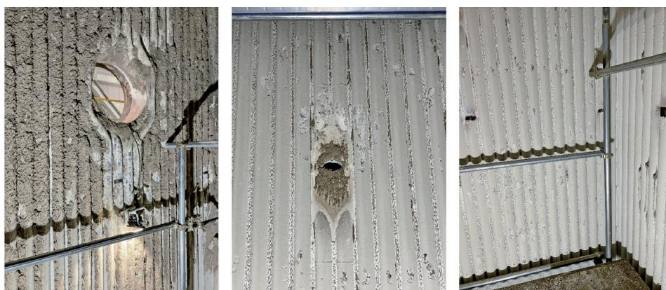
図6 試験終了から6日後のボイラ内部（左：洗浄範囲外，中央・右：洗浄範囲内）
