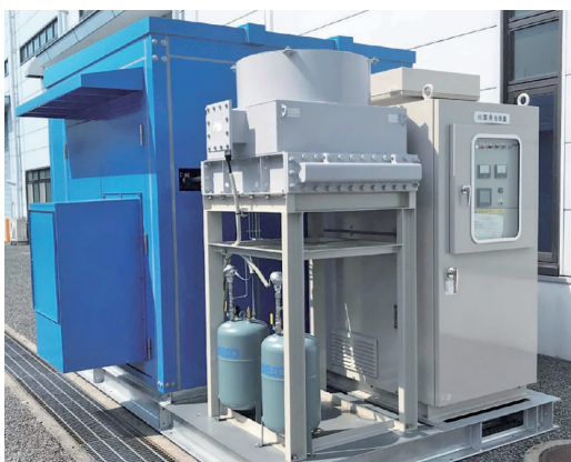
写真3 HHOG オールインプラン (10 Nm 3 /h)
