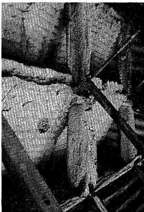
写真 2 閉塞した充填材 Photo.2 Filling clogged by scaling
