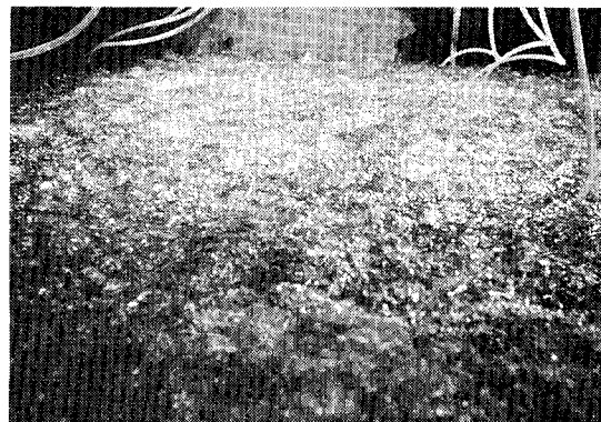
写真 5 空気と水の同時逆洗 Photo. 5 Air and water backwash
