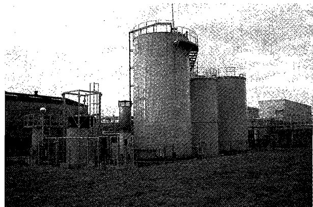
写真 3 2001年納入設備 全景 Photo 3 System delivered in 2001 (Retrofit)
