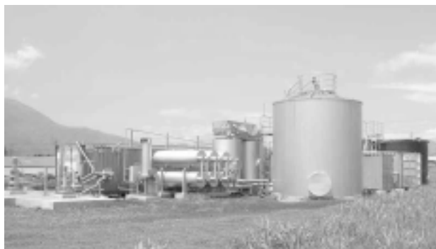
写真5 デモプラント Photo 5 Demonstration plant
