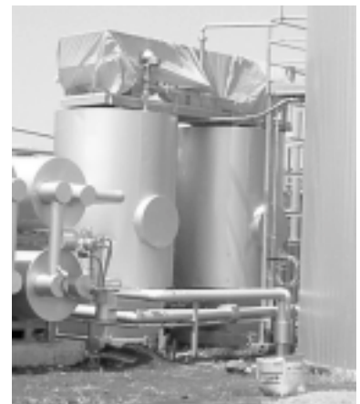
写真 4 衛生化タンク Photo 4 Pasteurization tank
