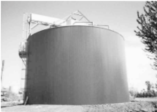
写真 2 機械攪拌式消化槽 Photo 2 Reactor
