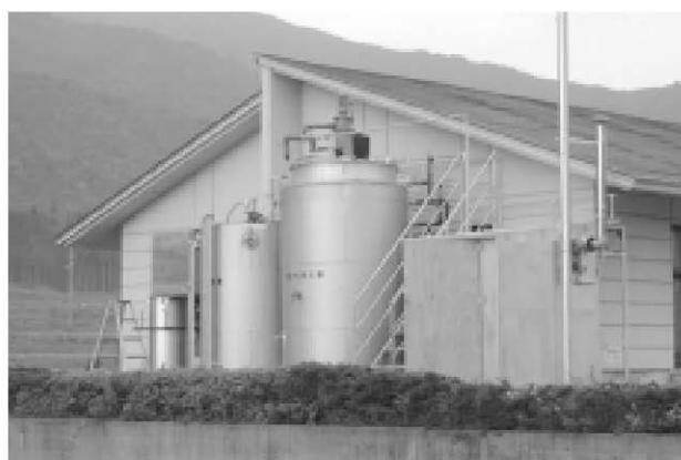
写真1 実証試験設備の全景 Photo 1 Test equipment
