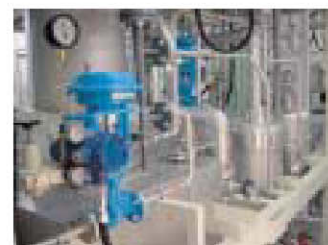
—溶剤再生ステーション— 使用後の溶剤を蒸留・再生する
