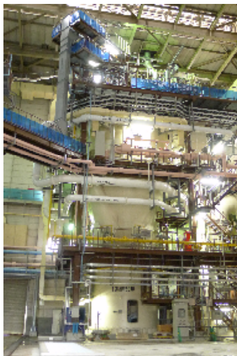
汚泥焼却炉（東部スラッジセンター） 【神戸市建設局提供】
