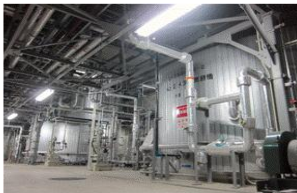
バイオガス設備 (あべのハルカス)
